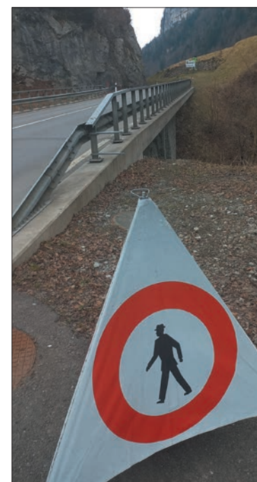
Gefährliche Situationen im Schlattli: Beim Brückengeländer sieht man noch die Metallhalterung von der vorher angebrachten Fussgänger-Verbotstafel. Heute stehen Faltdreiecke als Hinweise aufs Durchgangsverbots dort – leider halten sich aber viele Personen nicht daran.
