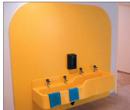
Ein Hingucker sind die kindgerechten Waschbecken im Kindergarten.
