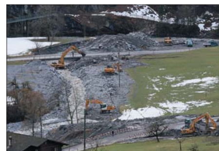
Nach dem verheerenden Murgang vom 31. Januar 2016 im Teufbach begann man unverzüglich mit den Aufräumarbeiten.
