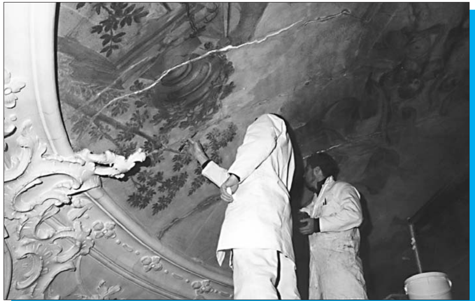
Die «Bilderchirurgen» Ruedi Stöckli und Gehilfe füllen die Risse an Deckengemälden mit verschiedenen Schichtdicken aus. Damit erreichen sie, dass der derselbe Mörtelaufbau wie an der Kuppel.
